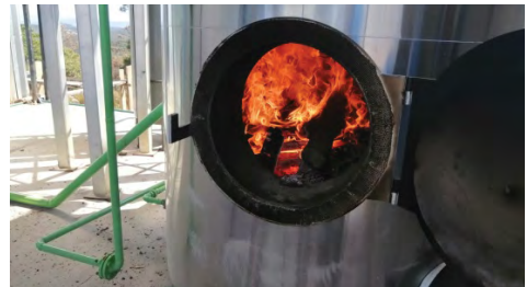
Imagen 130. Caldera de biomasa como fuente de energía.
