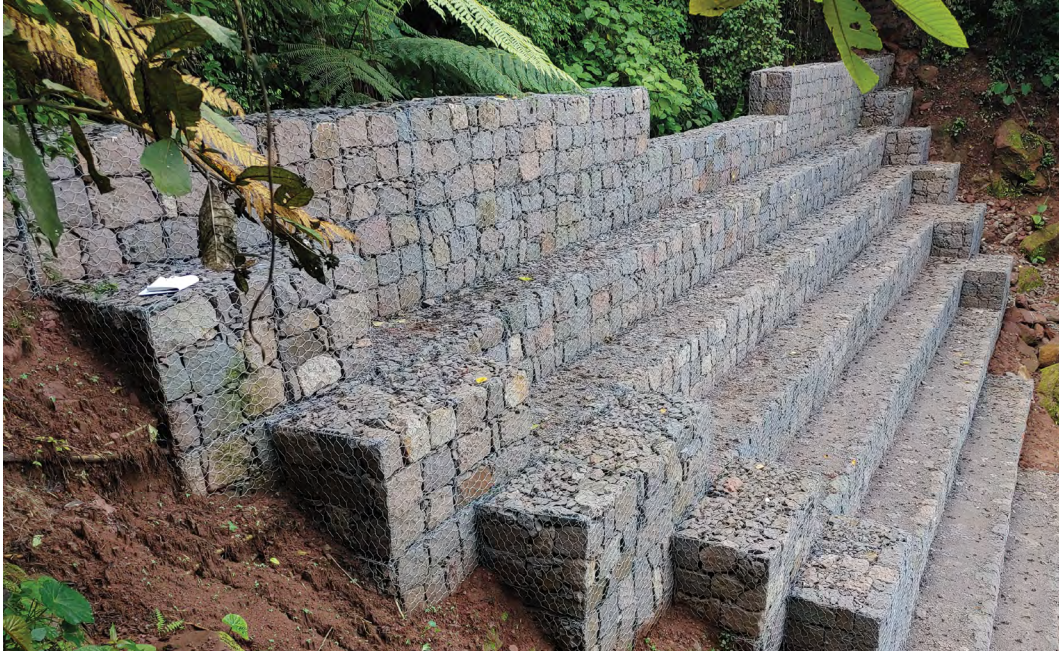
Imagen 66. Presa de gaviones para retención de suelo.
